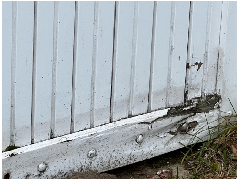
De slechte toestand van de onderzijde:
