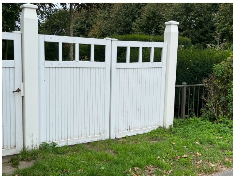
De hele constructie staat uit het lood:
